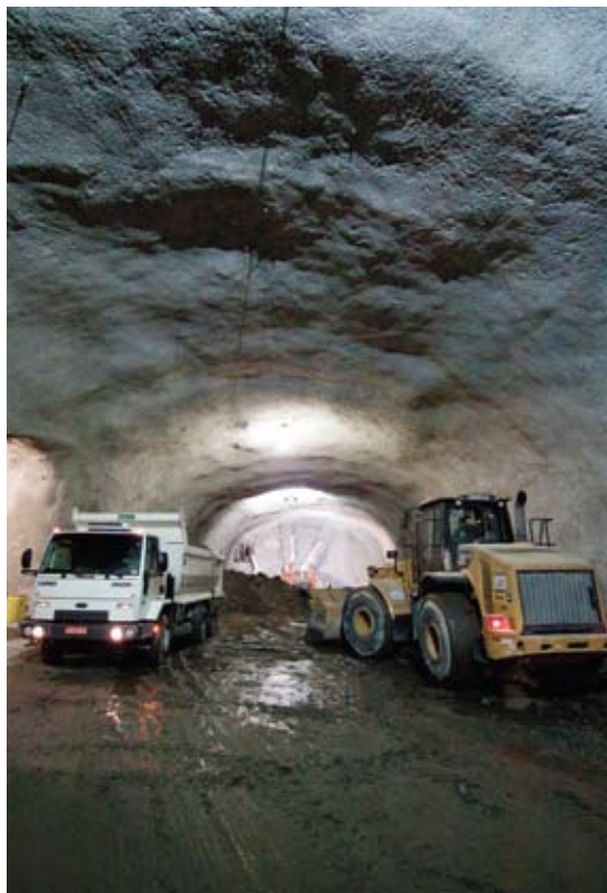
Obra da Linha 4 que ligará a Barra da Tijuca a Zona Sul do Rio Line 4 construction works connecting Barra da Tijuca and the South Side
